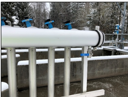
Prise pour le raccordement de l'équipement de nettoyage par acide
