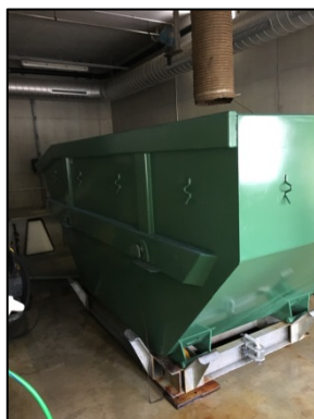
Benne à boues partiellement déshydratées
