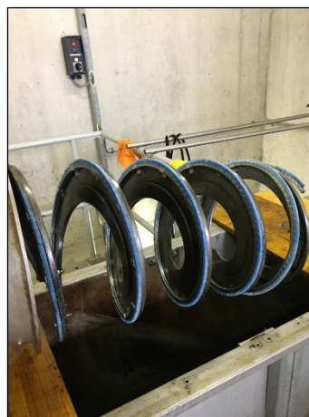
Nouvelle brosse d'entrée d'ouvrage
