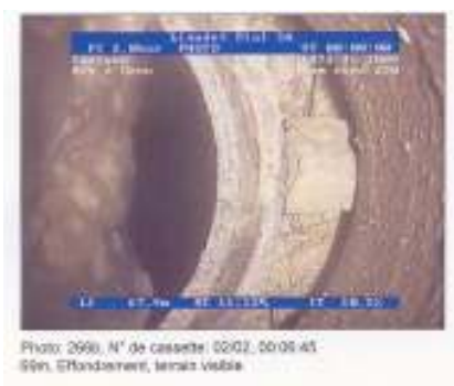
Ecrasement du tuyau par le tassement du terrain
