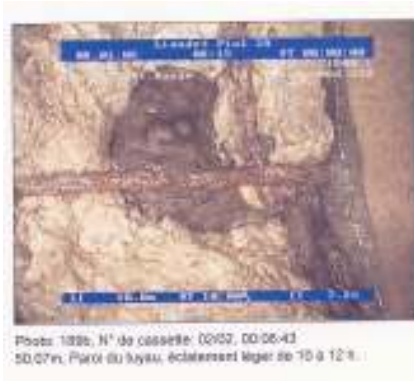
Eclatement léger de la paroi du tuyau
